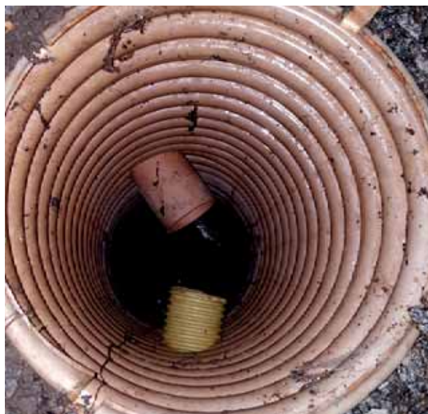
Tillsynsbrunn med sandfång i botten.
