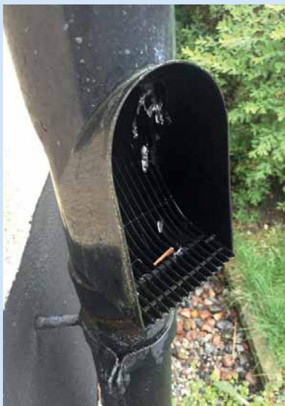
Lövsil monterad på stuprör.
